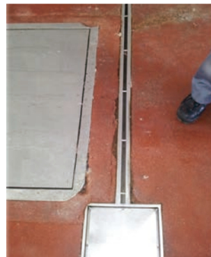
Roturas laterales por hundimiento del saneamiento.
