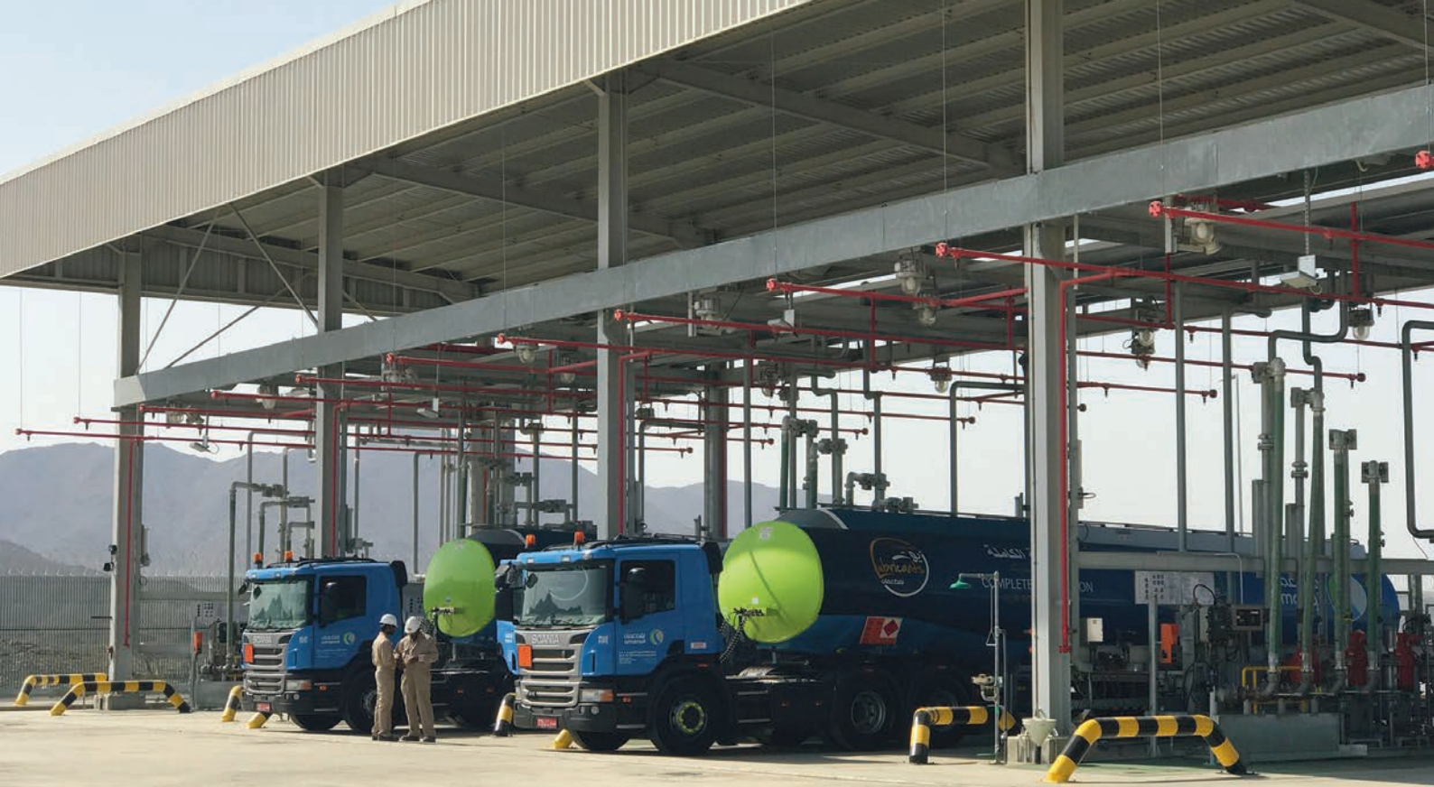
La compañía ha puesto en servicio recientemente una nueva instalación de almacenamiento en el Sultanato de Omán.
